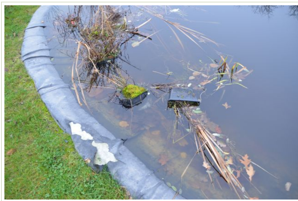
Dégâts suite à une mauvaise intégration de la bâche dans le sol. Une large bande de bâche est aussi visible et peu esthétique. (ECOWAL©)
