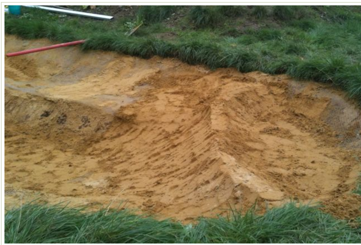
Le grillage de protection est inséré dans l'épaisseur de sable jaune. Des contre-pentes sont réalisées pour créer des poches de plantations. (ECOWAL©)
